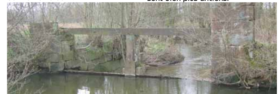
Photo Claude Paul SCHMITT du barrage de Gunstett. La Sauer coule de droite vers la gauche. En face, le Bieberbach, lit du cours d'eau naturel qui sert de déversoir, en particulier pendant les crues.
