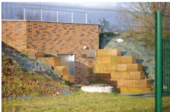
Réservoir d'eau potable
